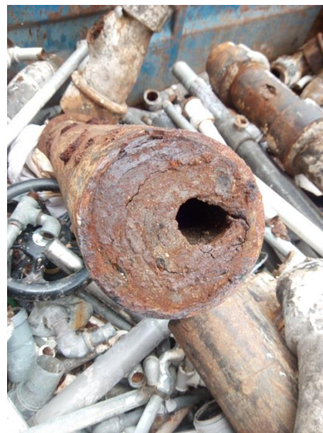
Fotografi af et afløbsrør fra ejendommen, hvor man kan få et indtryk af, hvor tilstoppede afløbene har været.
