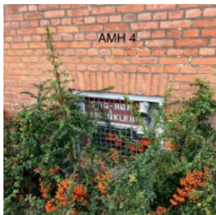
Skilt på hvert rør, hækklippes ned, udløb skal beskrives.
