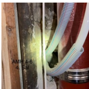
Aksels Møllers Have 4-6, 4. sal.- rør og hul i væg
