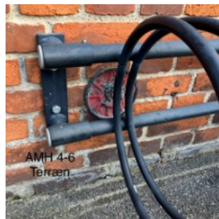
Skilt med brandmur skal være tydeligt og skal placeres ved alle brandmure
