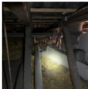
Aksels Møllers Have 6 - Hul på beton kanal
