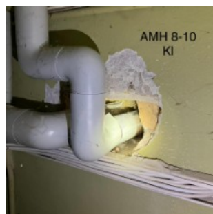
Aksels Møllers Have 8-10, kl. - rør og hul i loft
