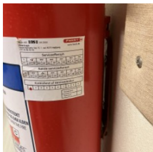
Håndildslukker med serviceeftersyn - OK
