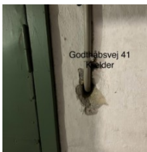
Godthåbsvej 41 - Ledning i væg
