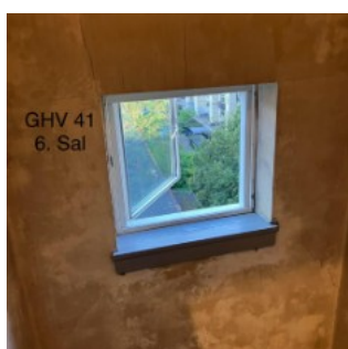
Røg udluftning i trapperum
