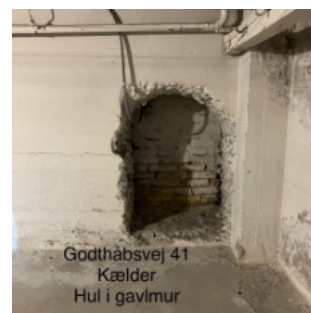
Godthåbsvej 41 - Hul i gavlvæg
