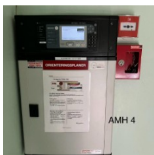
ABA central - Service udført i 2024
