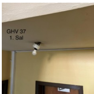
Fatning er revet ud af loft, skal monteres korrekt
