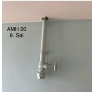
Aksels Møllers Have 20, 9. sal - Sprinkler gennem loft skal lukkes
