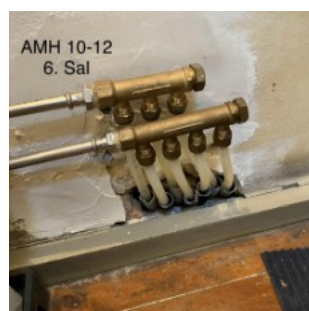
Aksels Møllers Have 10-12, 6. sal. - rør og hul i væg
