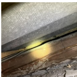
Aksels Møllers Have 6 - Brandkarm over elevatorskakt svarer ikke til udførsel i dag
