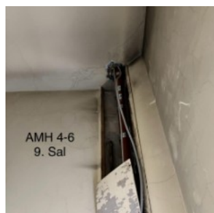
Aksels Møllers Have 4-6, 9. sal.- rør og hul i loft
