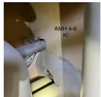
Aksels Møllers Have 4-6, kl.- rør og hul i væg
