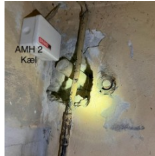
Aksels Møllers Have 2, kælder - Hul i væg
